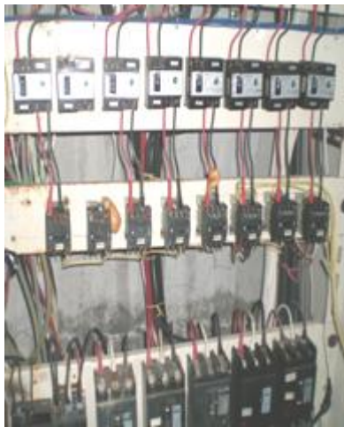
圖一、溫泉 SPA 用泵之配電箱
