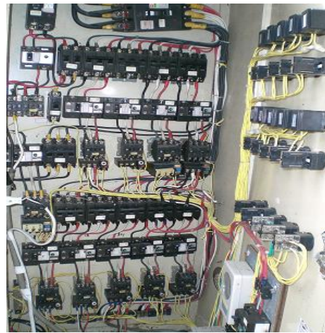
圖二、冷水機用之電源配電箱
